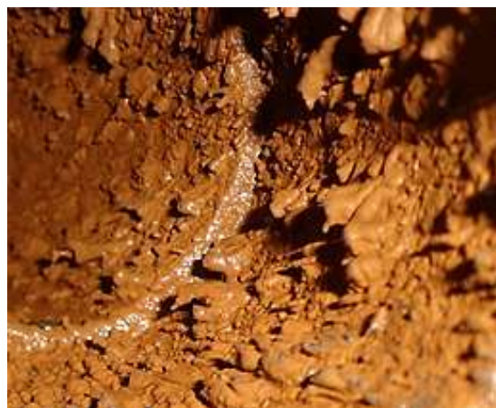
Рисунок 3 – Микробиологическая коррозия в элементе конструкции системы охлаждения дизеля
