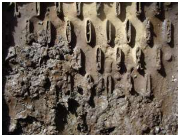
Рисунок 1 – Состояние системы водоохлаждения ДВС тепловоза
