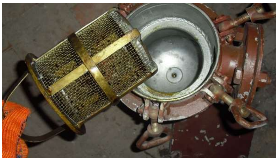
Рисунок 6 – Кингстонный фильтр забортного контура системы охлаждения
